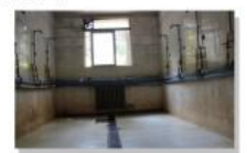
学生男女浴室维修前照片
